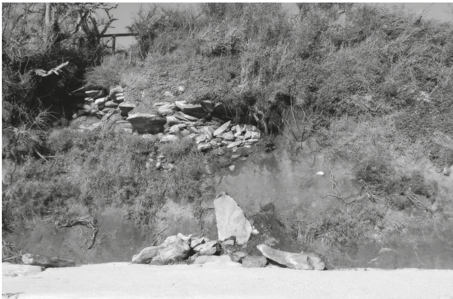
Figura 2. Colapso da rampla de acceso ás factorías, identificado a inicios do ano 2024.
