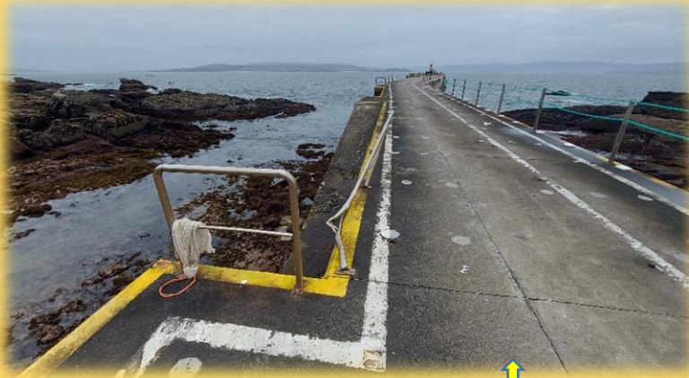
A varanda do peirao un pouco deteriorada por varias partes.
